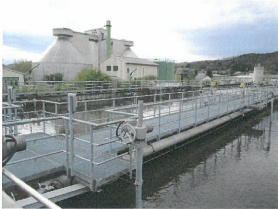
Belebungsbecken und Faultürme
