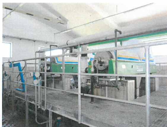
Klärschlammwässerung mittels Zentrifugen
